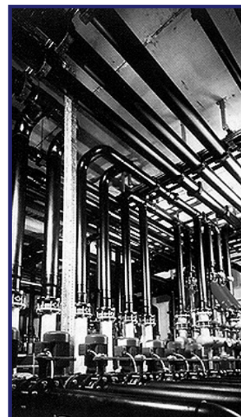
Figura 6 - Centrale distribuzione acqua di raffreddamento in PE 100 Figure 6 - Cooling water distribution pipes out of PE 100
