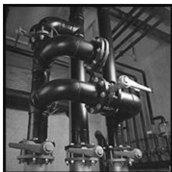
Figura 3 - Tubazioni di processo in PE 80 Figure 3 - Piping system out of PE 80
