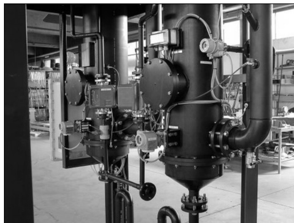
Figura 6 - Unità di abbattimento gas inquinanti in PPS EL Figure 6 - Scrubber unit for gas treatment out of PPS EL
