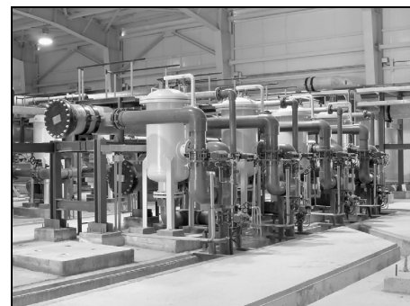
Figura 9 - Linee di collegamento a incollaggio chimico nell'impianto trattamento acque Figure 9 - Connection line with chemical bonding joints of a water treatment plant
