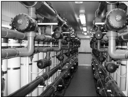
Figura 1 - Collettori distribuzione acque trattate Figure 1 - Filtered and process water distribution manifold
