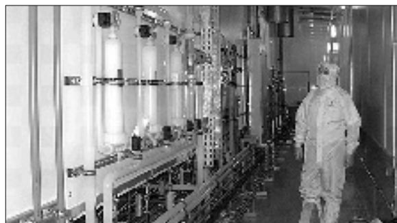
Figura 2 – Controllo funzionamento impianto di distribuzione in PVDF Figure 2 – Function check of piping system out of PVDF
